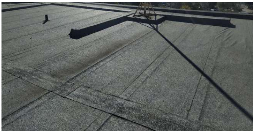
Φωτογραφία 4: Φθορά στην οροφή του κεντρικού κτιρίου των Διοικητικών Υπηρεσιών
